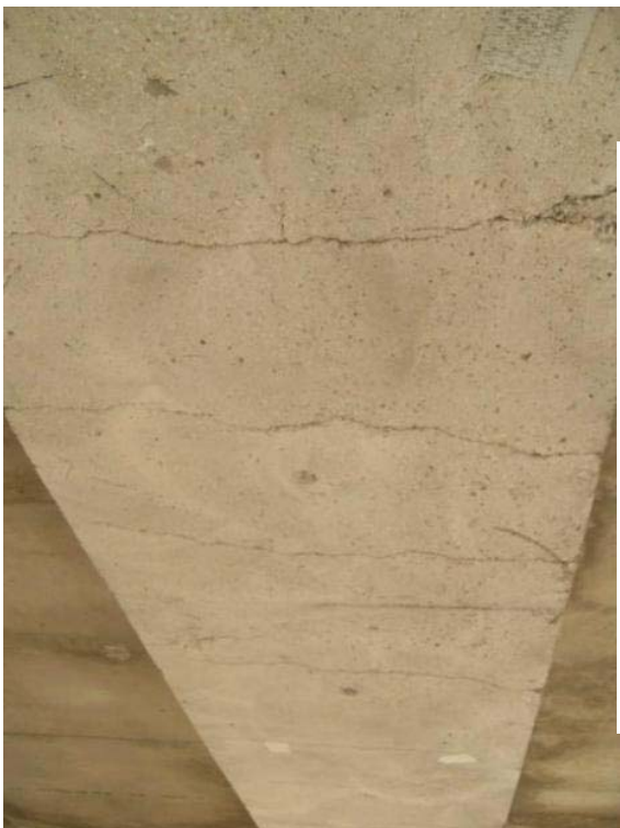
عکس روبرو: نمونه ترکهای موجود در تیرهای سازه قبل از تقویت
